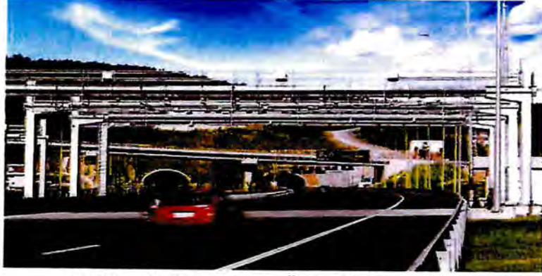
Çok Şeritli Serbest Geçiş Ücret Toplama Sistemi
