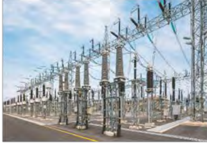
Trafo Merkezi Çelikleri
